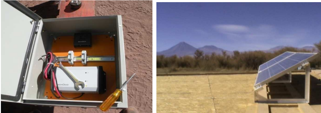
Figura 5. Izquierda: Tablero eléctrico. Derecha: Sistemas fotovoltaicos instalados. Fuente: Soc. Eolétrica Ltda.
